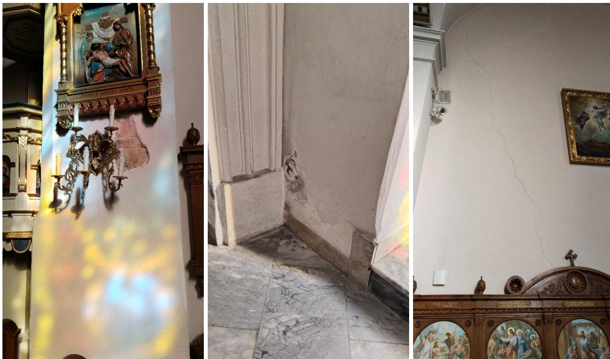
Zdjęcie 2. Fotografie ukazujące potrzebą podjęcia działań remontowych i modernizacyjnych budynków zabytkowych- kościół pw. św. Andrzeja Apostoła w Broku
