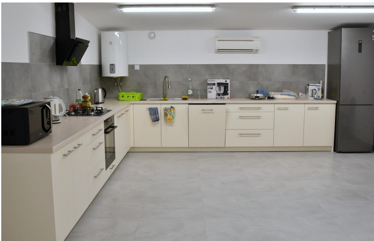
Kuchnia w budynku świetlicy – ul. Czuraj w Broku.
